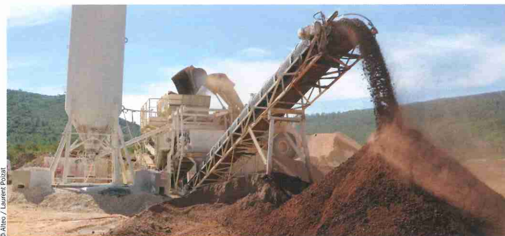
Préparation d'une couche de forme routière obtenue en mélangeant de la Bauxaline et un liant, le Gardanex. On corrige ainsi l'état hydrique.
